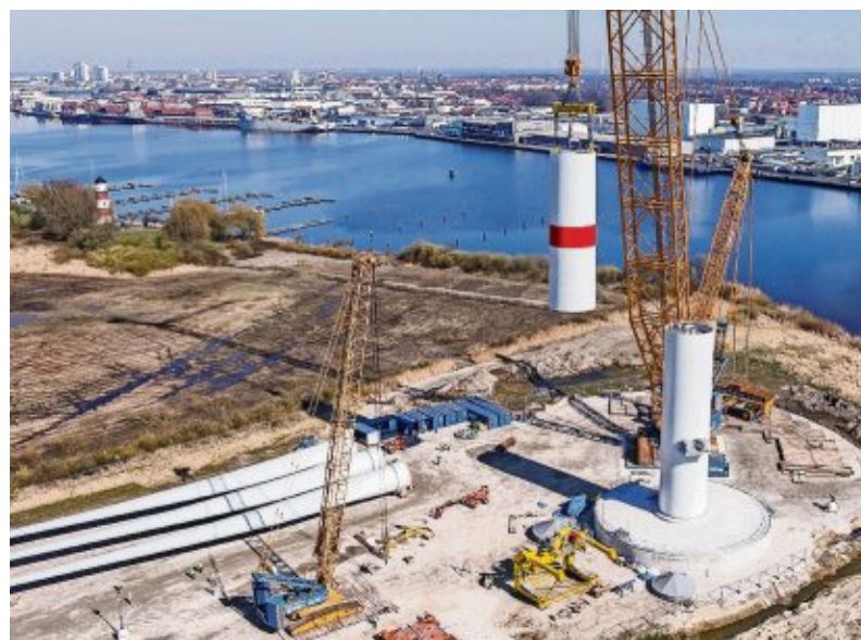
Layout und Choreografie der Baustelle sind bis ins letzte Detail durchdacht, damit die Montage reibungslos vonstatten geht.
